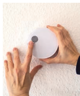
Die Monteurinnen und Monteure der sidur dürfen auch während der Pandemie für Installation und Wartung von Rauchmeldern die Mietwohnungen ihrer Kunden betreten
